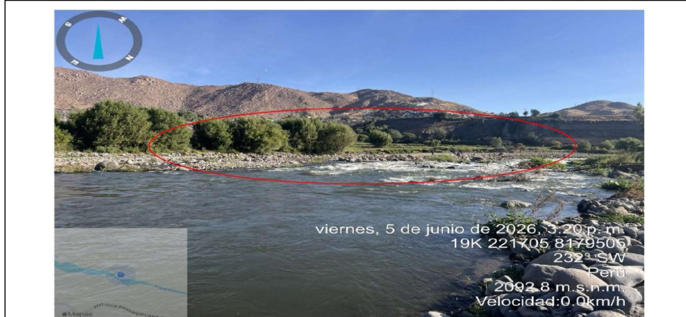
Figura n.º 02 de la FTR: Se observa la erosión en las márgenes, por lo que con el material propio de la descolmatación se deben conformar bordos.
